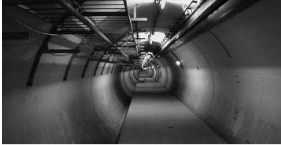
Mehr als 40 Kilometer Tunnelanlagen sind beim CERN zu schützen. Noch ist der Tunnel für den Protonenbeschleuniger LHC leer, doch in wenigen Monaten wird er mit technischen Anlagen gefüllt sein.
