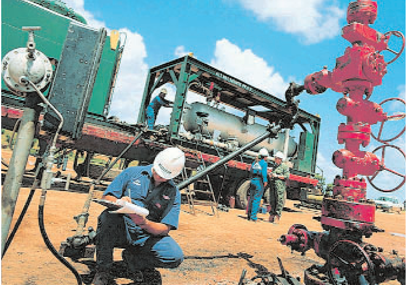
Teil einer Ölförderanlage in Venezuela: Tagesförderung von 4 Millionen Fass.
